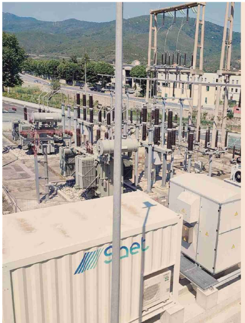
Fast reserve. Il sistema di accumulo di Renantis nel porto di Vado Ligure
